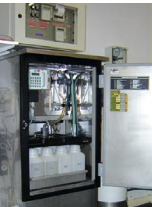
Figuur 7 Automatische bemonsteringsinstallatie voor rivierwater (deel uitmakend van de TELERAD-riviermeetstations).
